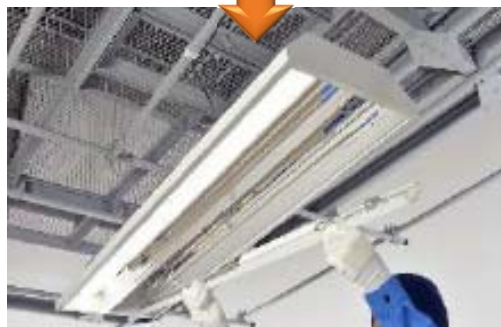
固定クリップとコネクタを外し、 新しいLEDユニットと差し替える
